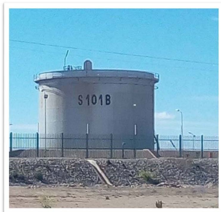
Figure III.4 : Bac de détente (S-101B)
