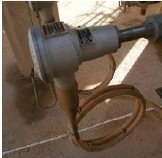
Figure III-6 : Transmetteur de température TT303.
