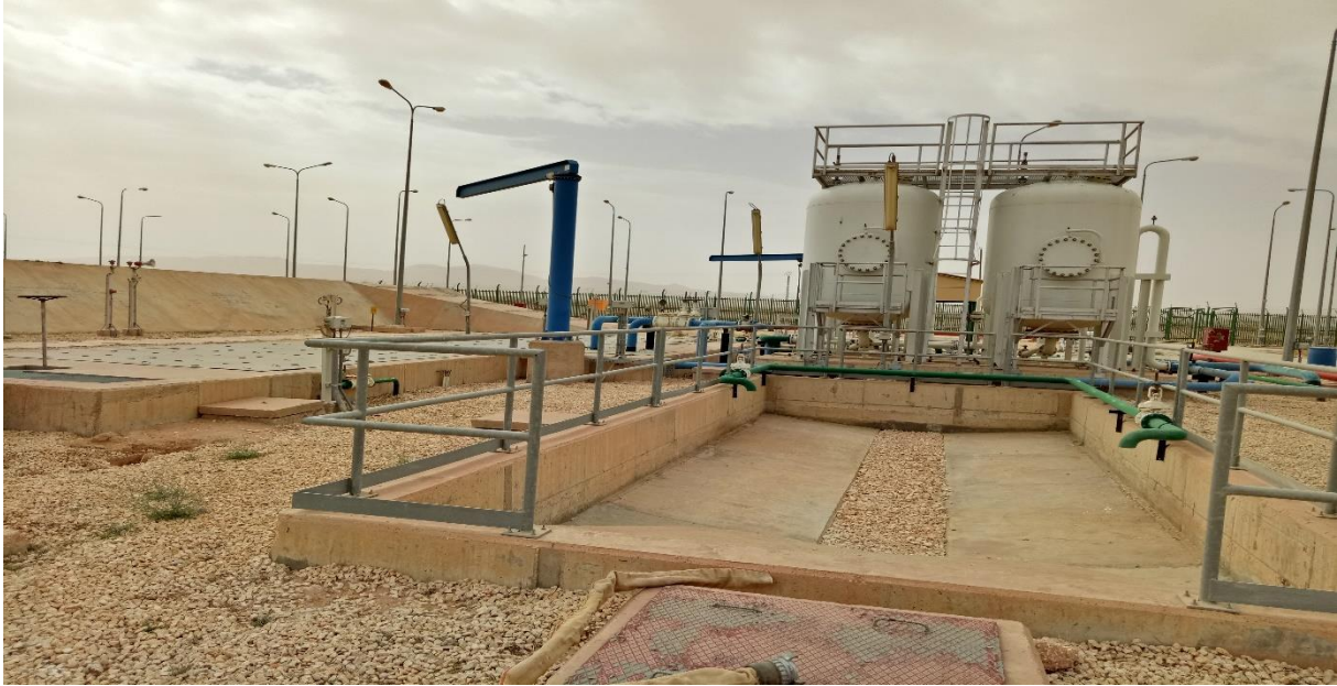
Fig. I.7: Traitement des eaux huileuses.
