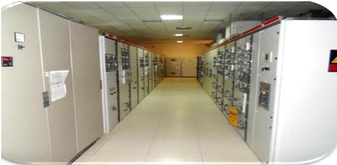
Fig. I.12 : La Salle électrique.
