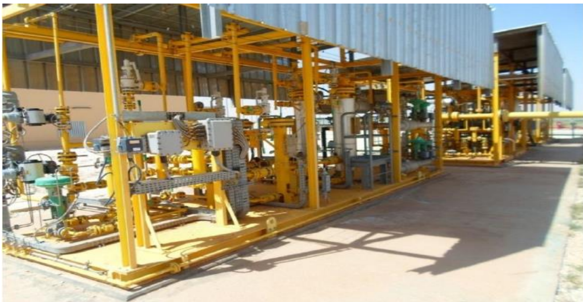
Fig. I.8 : Le Skid Gaz.
