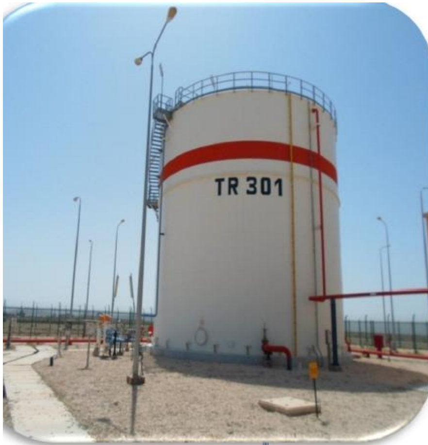
Fig. I.9 : Bac de stockage d'eau d'incendie.
