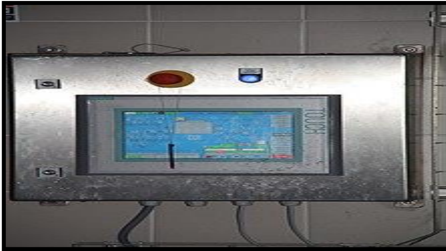
Figure III.2 : Coffret électrique avec écran de supervision monté en façade.
