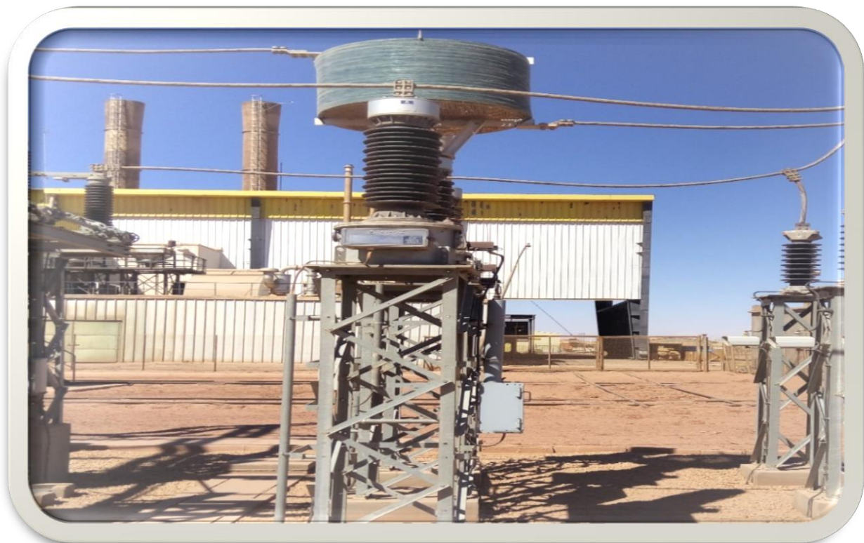
Figure I .22 : Transformateurs de tension (SONATRACH SH DP IN AMENAS).
