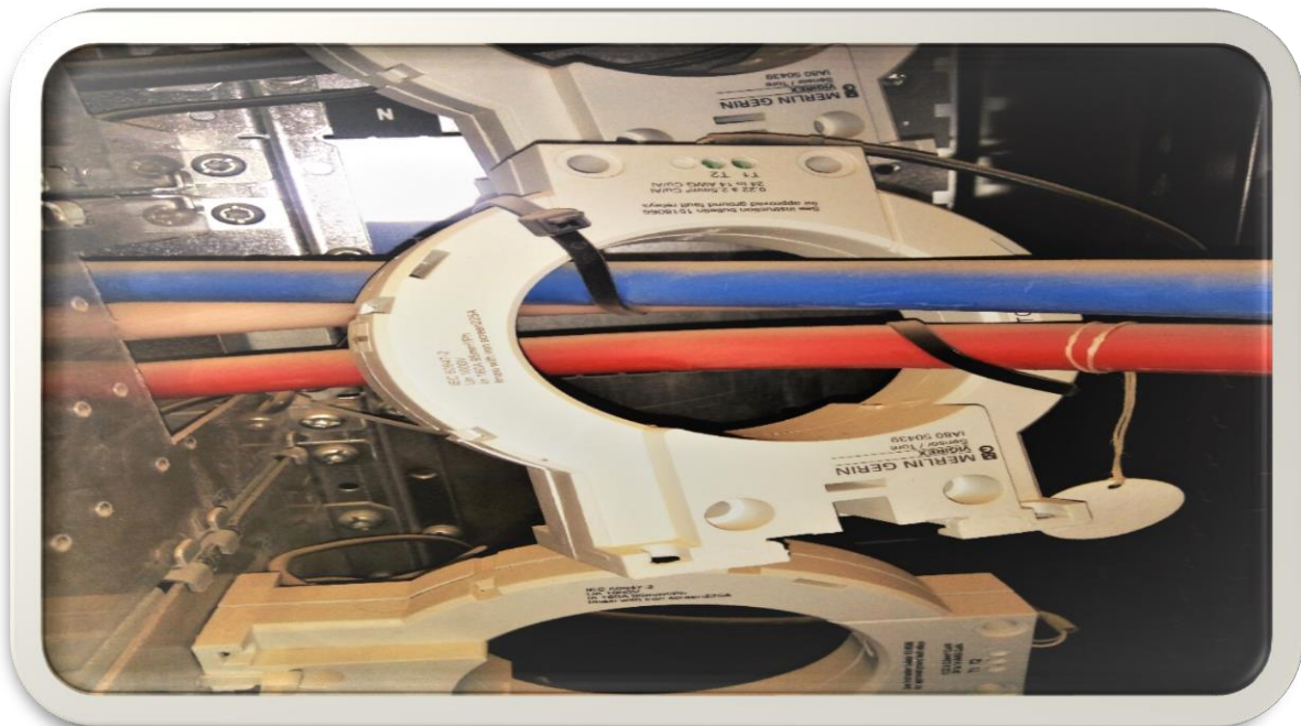
Figure I.17 : Transformateur de courant torique résiduel (SONATRACH SH DP IN AMENAS).
