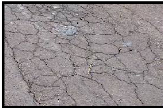
Figure II.21 : faïençage dans les bandes de roulement
