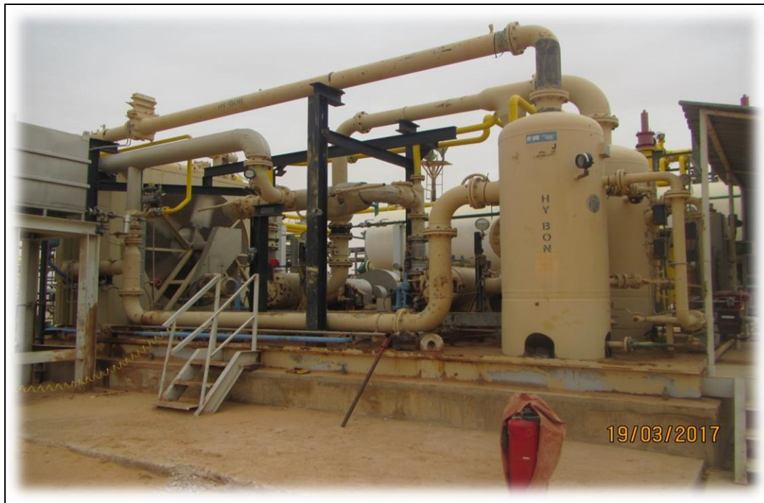
Figure IV.1. L'unité VRU (Unité de récupération des vapeurs) centre GS1
