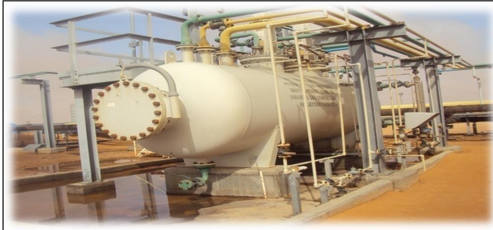
Figure III.13. Séparateur triphasique au AR06 centre d'El Agreb
