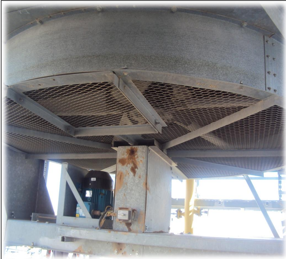
Figure IV.10. refroidissement du gaz par un aéro réfrigérant a New Zotti.
