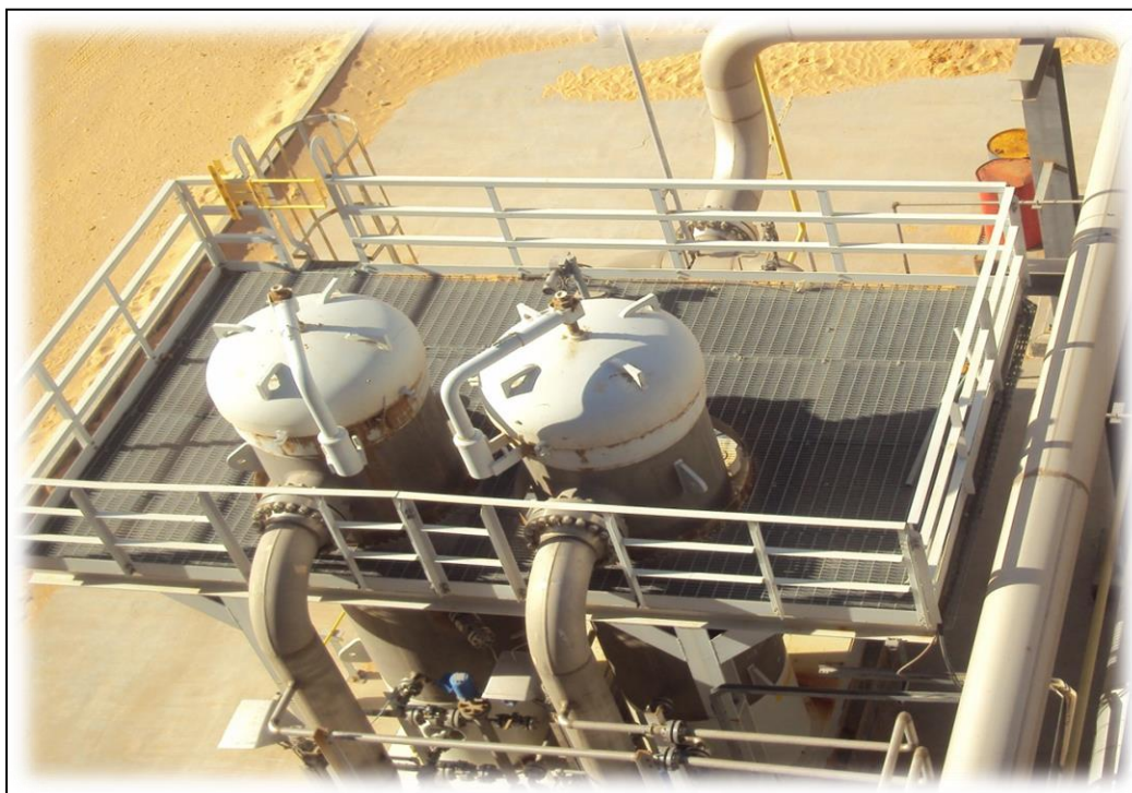
Figure IV.14. Les Filtres (humide et sec) de l'unité de déshydratation a New Zotti
