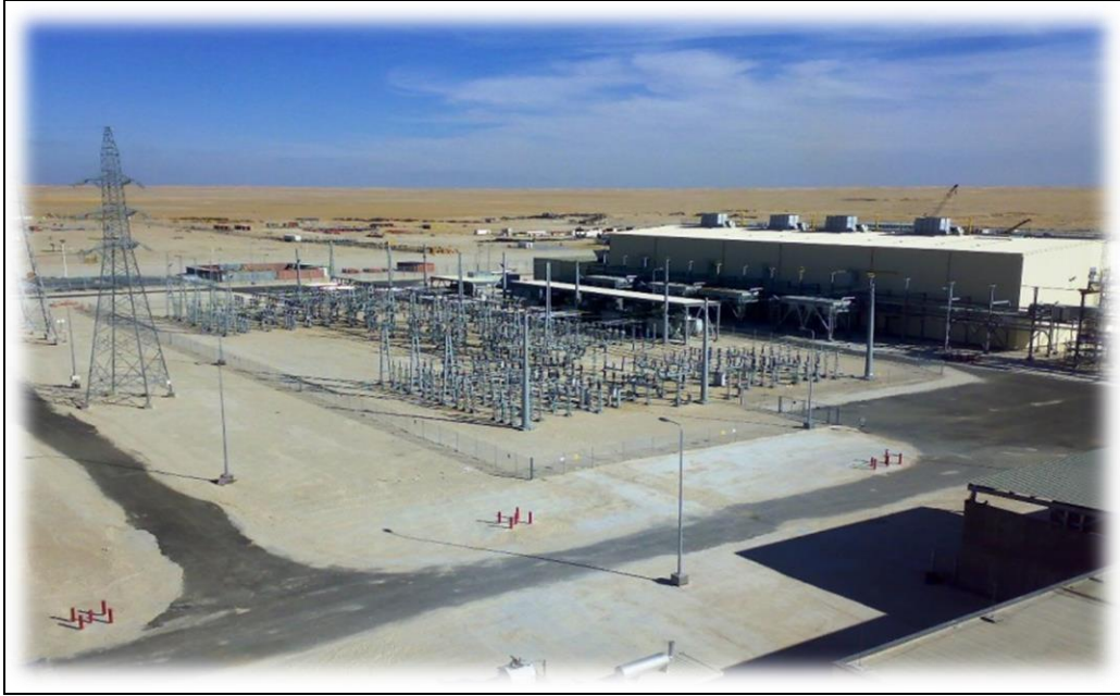
Figure IV.18. La centrale électrique a New Zotti
