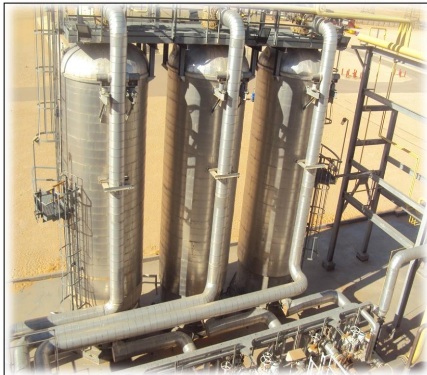
Figure IV.11. Les trois sécheurs de l'unité de déshydratation a New Zotti.
