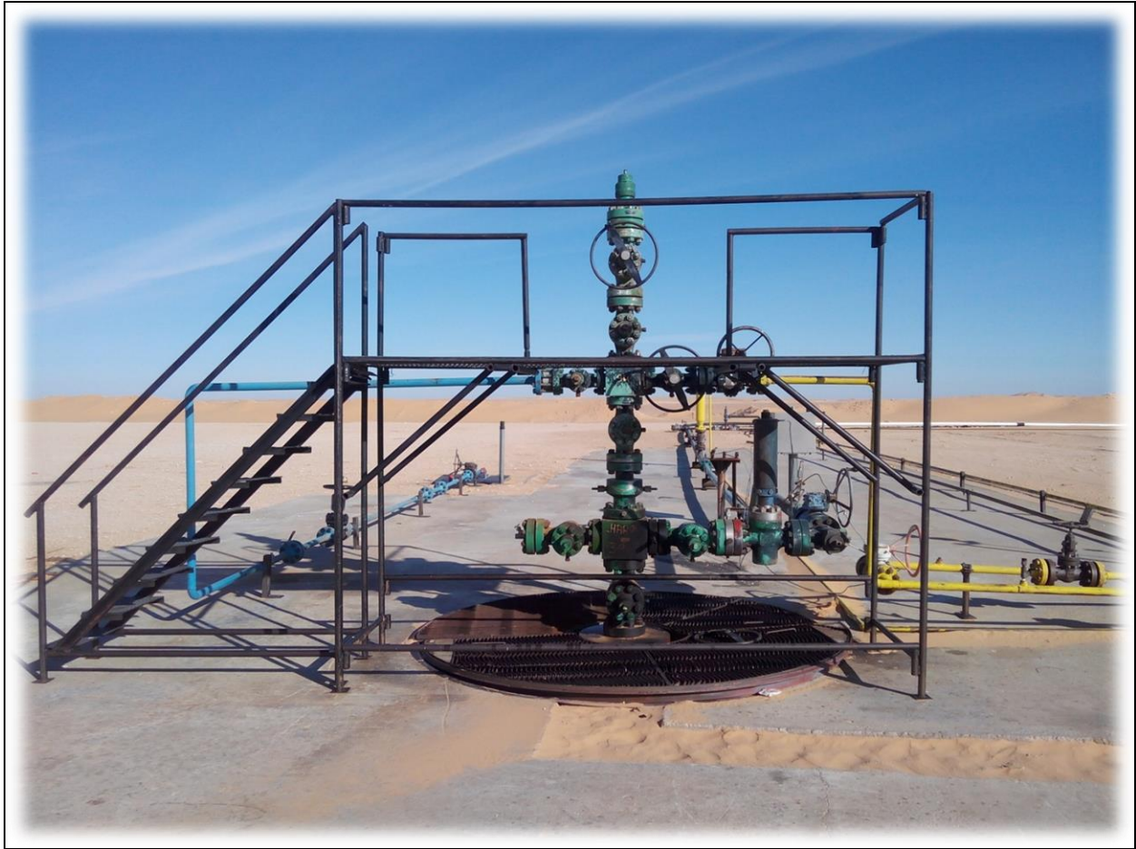
Figure V.20. Puits producteur à gaz lift GL a GEA
