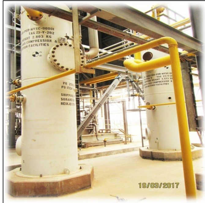
Figure IV.4. Les Ballon d'aspiration et de refoulement au centre GS1
