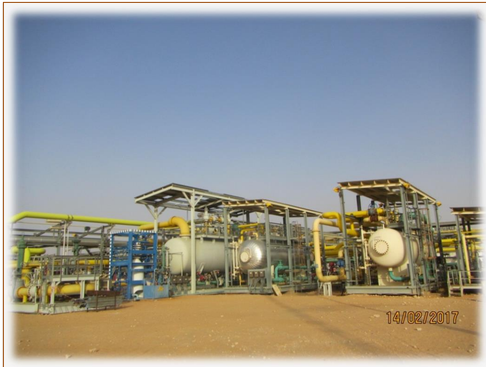
Figure I.3 : Les trois séparateurs tri phasique au centre GS1 - Gassi El Agrab Région Hassi Messeoud
