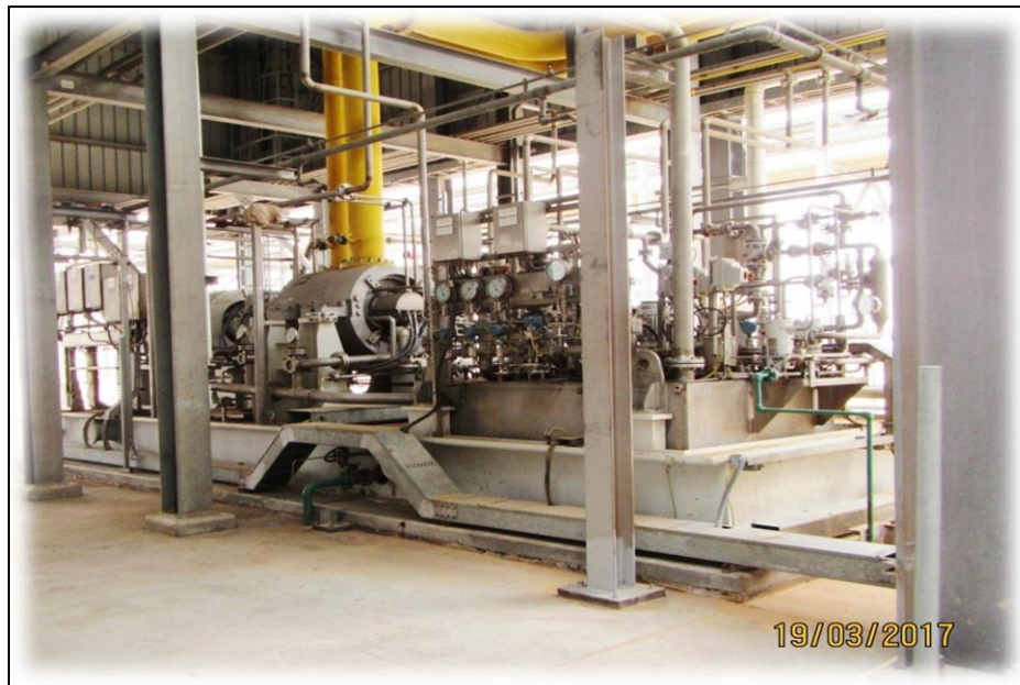
Figure IV.3. Compresseur HP du gaz associé au centre GS1
