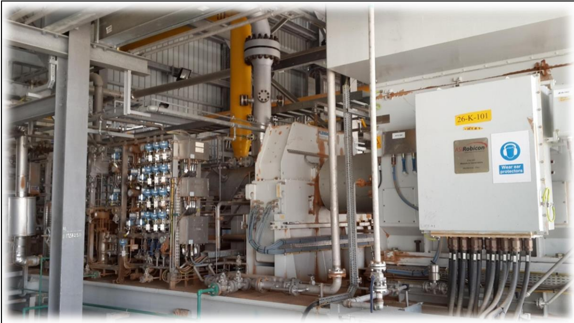
Figure IV.16. Compresseur de gaz lift a New Zotti
