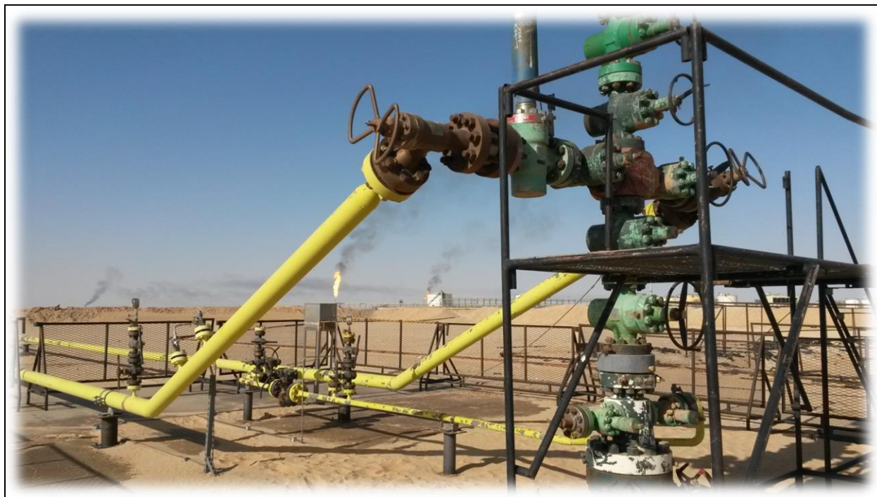
Figure IV.23. Puits injecteur de gaz miscible MF à GEA
