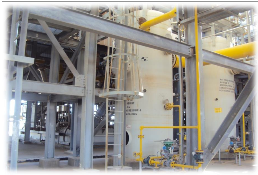
Figure IV.9. les ballons d'aspiration et de refoulements (Séparateurs Verticaux) a New Zotti.
