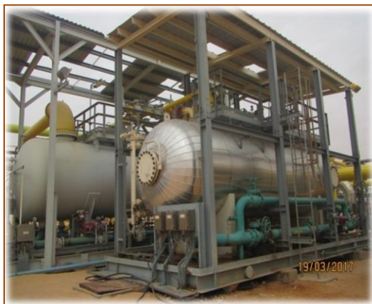
Figure I.4 : Séparateur LP ( Low Pressure )
