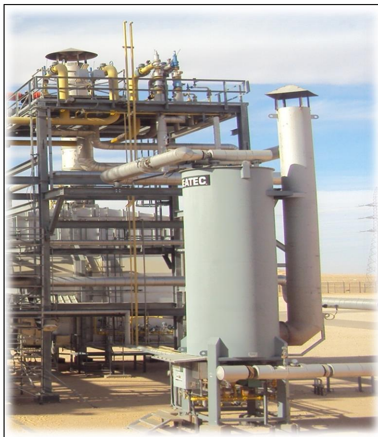
Figure IV.15. Le four de l'unité de déshydratation a New Zotti
