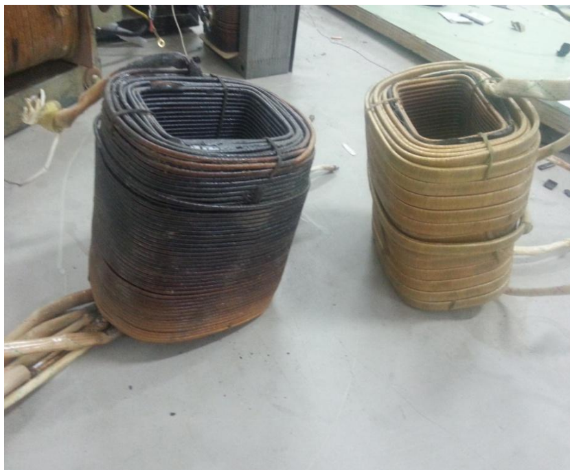
Fig.III.2a. Bobinage primaire endommagé (gauche) et bobinage secondaire saint (droit)
