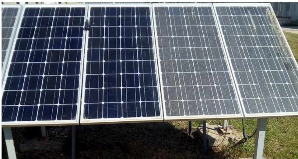
Figure IV-1 : les modules PV utilisés
