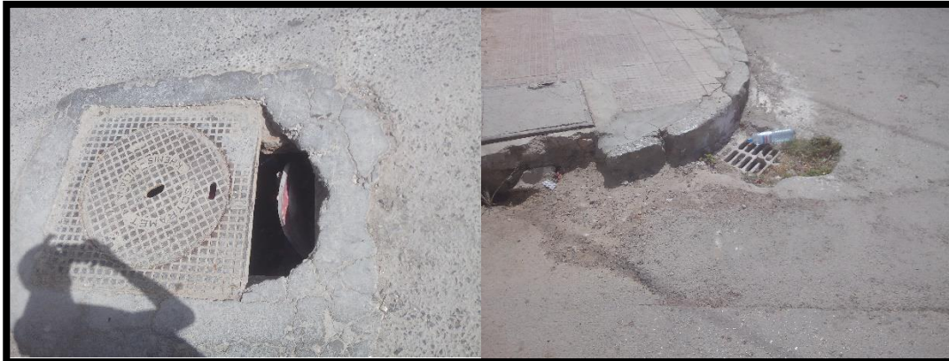
الشكل(6-23): صورة توضح الأضرار على مستوى بالوعات الصرف الصحي
