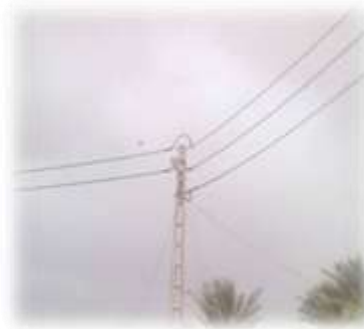
الصورة رقم 105: توضح شبة الكهرباء.
