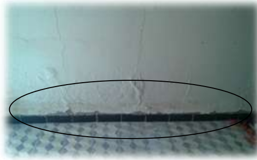
الصورة رقم 101: توضح تشقق على مستوى الجدران الغرفة. المصدر: من التقاط الطالبة 2018
