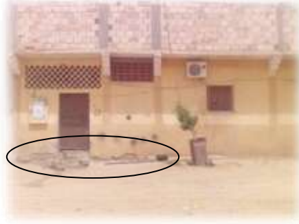
الصورة رقم 104: توضح واجهة مبنى مشوه. المصدر: من التقاط الطالبة 2018.
