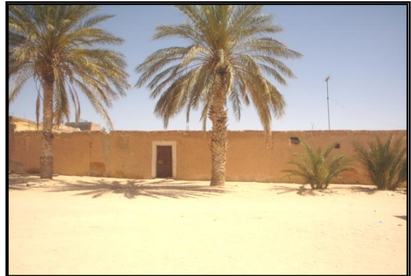
صورة 2 مبنى هش
