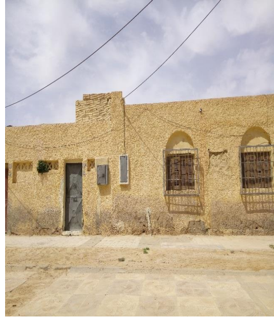
صورة 1 مبنى هش
