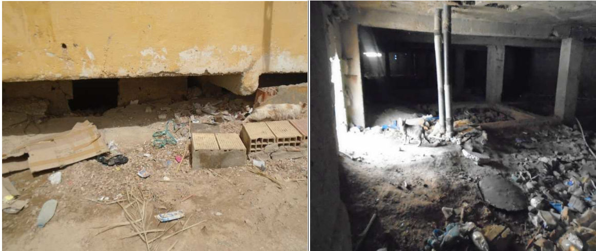
صورة رقم (14) : صرف الصحي داخل مبنى
