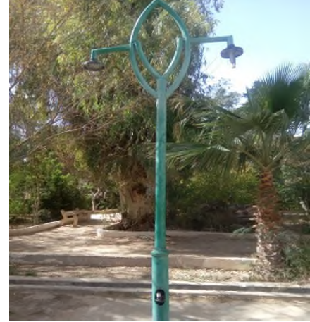
الشكل (4-53): اعمدة الانارة في منتزه كجويلية المصدر: من إلتقاط الطالبة دفعة جوان 2018.
