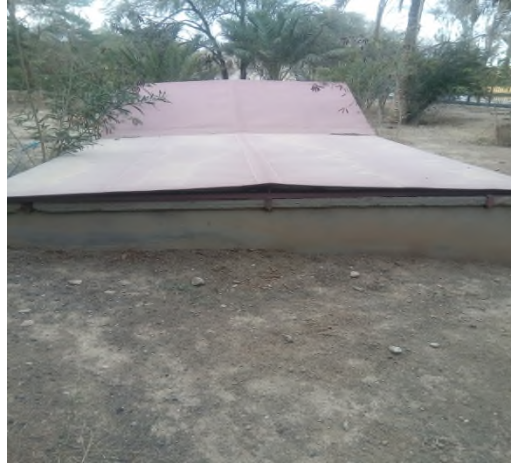
الشكل (4-19): تمثل خزان الماء لمنتزه لاندو
