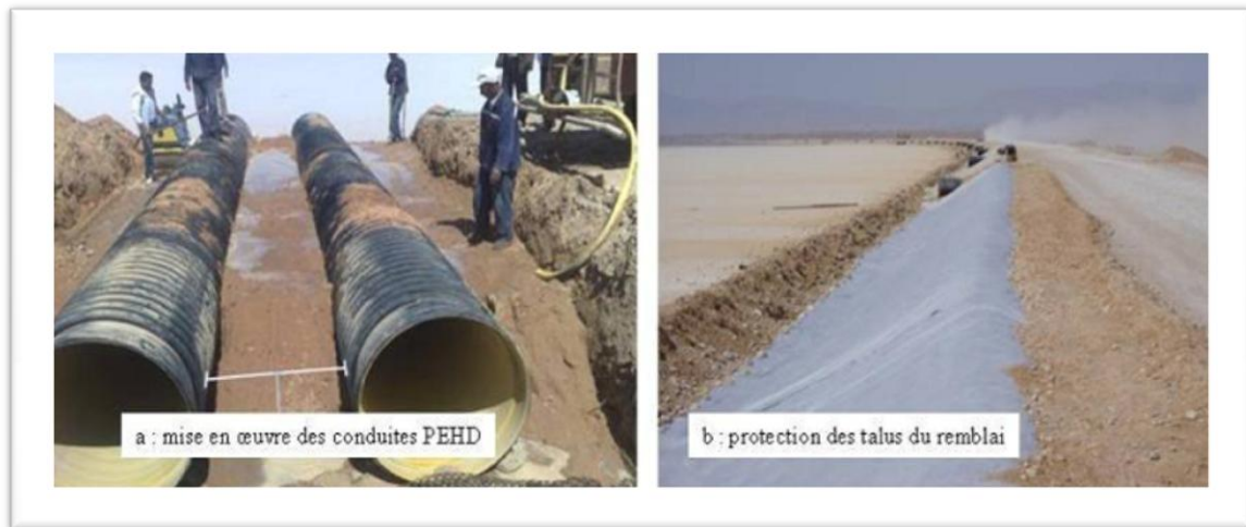
Photo. VIII. 4 : Mise en place des conduites PEHD (a) et protection des talus (b)
