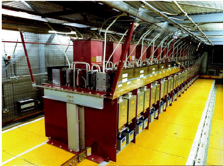
Figure (2.7) : Une valve de STATCOM (une phase)
