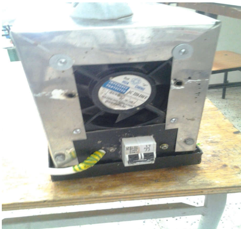
Fig.III.22. Système protection de poste.
