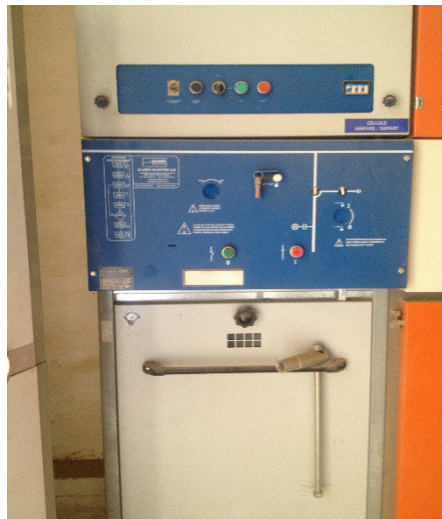
Figure 04-01 : Cellule de protection et de comptage
