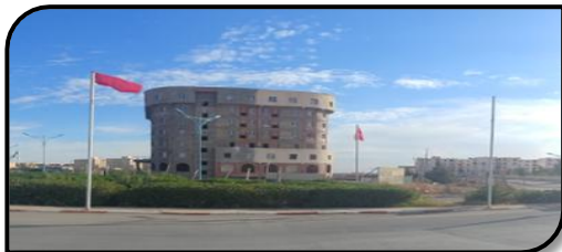
فندق زكريا نايل في طور الانجاز ويعتبر نقطة نداء للأرضية حيث يدعم الجانب الوظيفي للمنطقة
