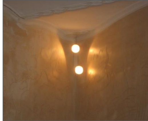
Figure 146: Éclairage artificiel insuffisant. (Source: auteur)
