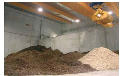
Figure 9: représente une chaufferie à bois.33 pour les besoins en électricité des parties communes.
