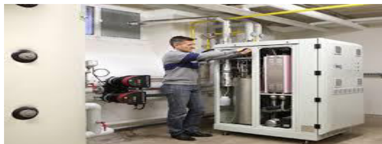
Figure n 28 : Une pile à combustible
