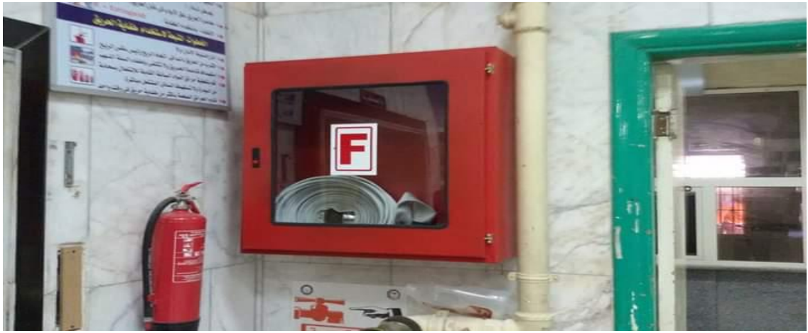
صورة تبرز وجود وسائل متعددة لإطفاء الحرائق ( خراطيم المياه + قارورات الإطفاء )
