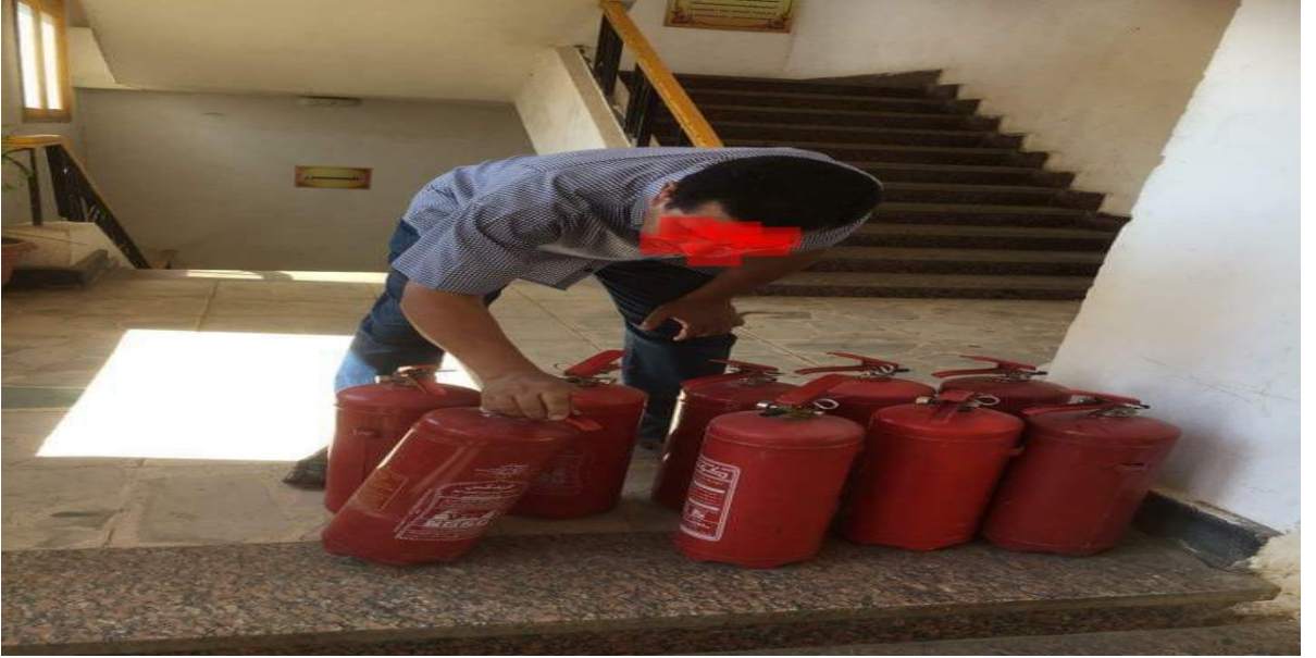
صورة تبرز الإهتمام بمراقبة قارورات إطفاء الحريق
