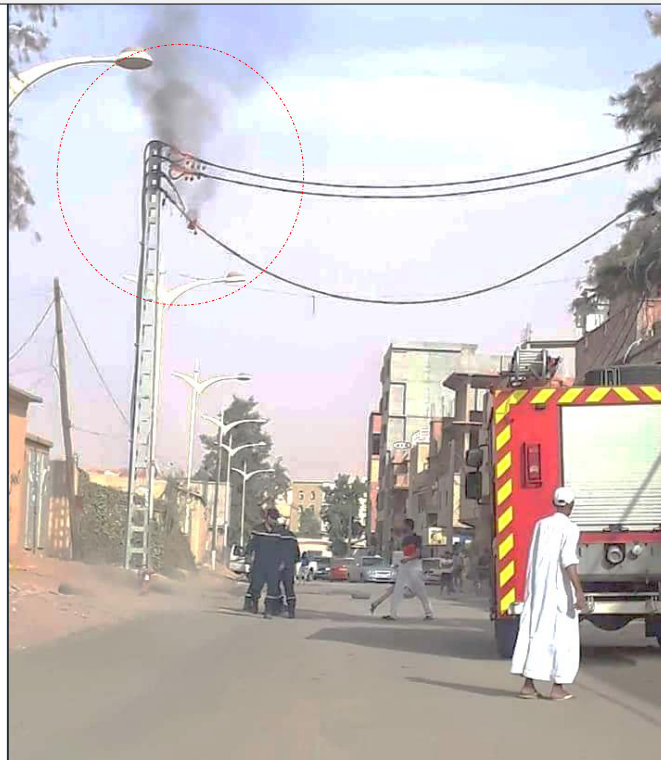
Photo 10 : Incendie d'une ligne électrique B.T
