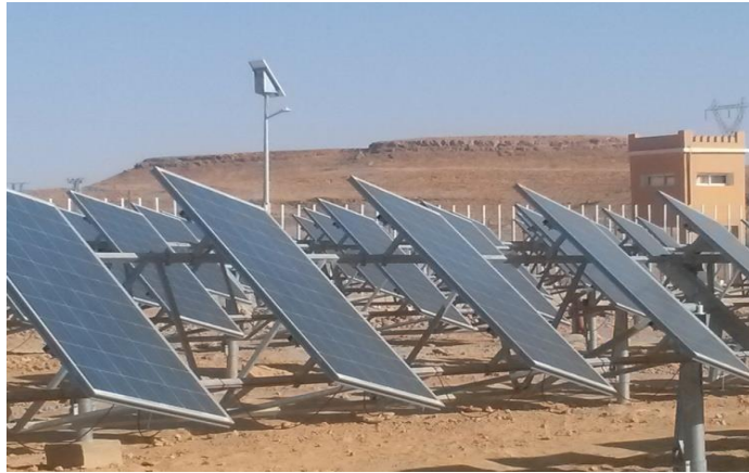
Fig( I.10 ) : Centrale photovoltaïques d'une puissance de 1.100 KWc d'Oued Nechou.
