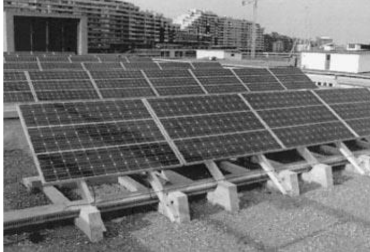
Fig( I.11) : Centrale photovoltaïque sur un bâtiment d'une puissance de 7.5 KW[12].
