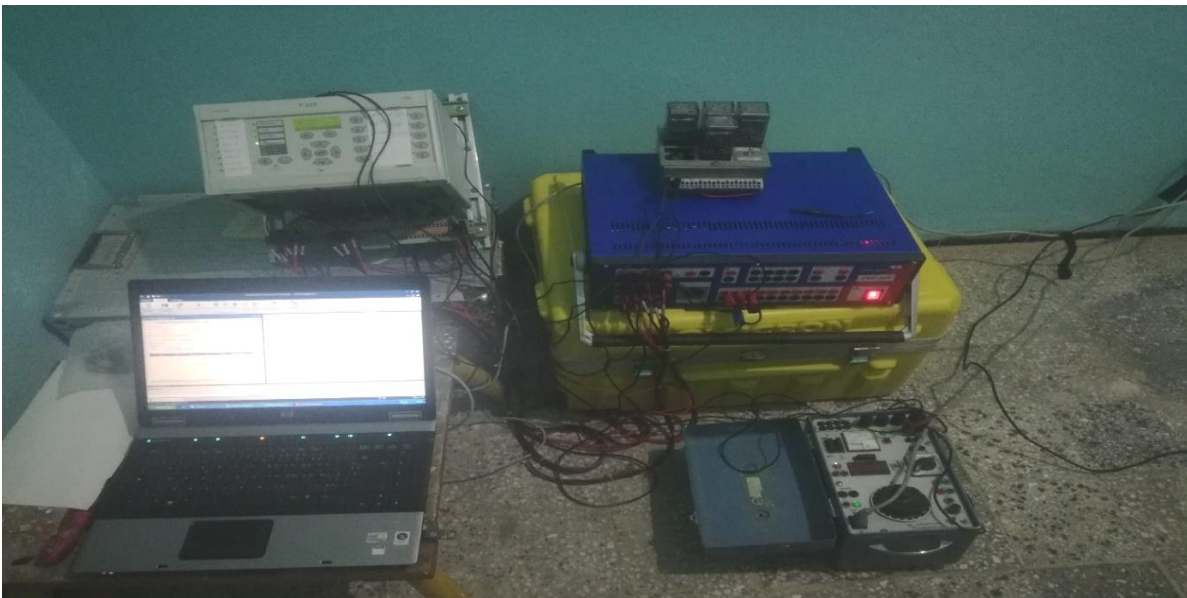
Fig. III.2 : Banc expérimental de test de la protection de distance réalisé au niveau de GRTE de Biskra.
