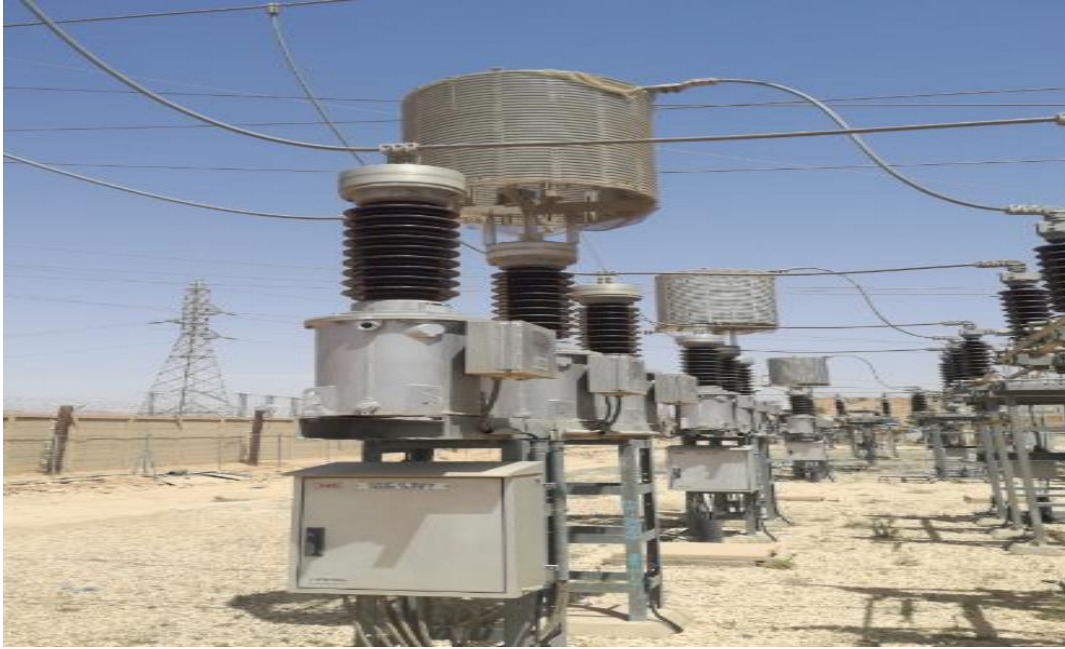
Fig.II.5 : Transformateur de tension installé au poste 220 kV GRTE Biskra.
