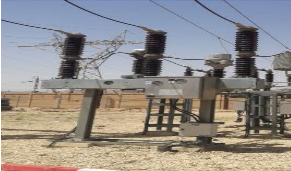
Fig.II.6 : Disjoncteur 60 kV à Gaz SF6 (poste 220 kV GRTE de Biskra)
