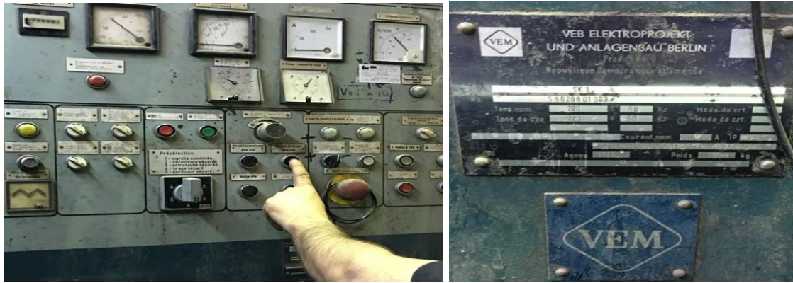
Figure II.19 L'armoire générale de commande de la chaîne.
