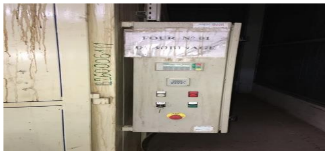
Figure III.47 Four de débobinage.
