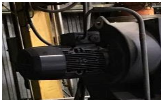
Figure II.16 Moteur à courant continu de la chenille de tirage.
