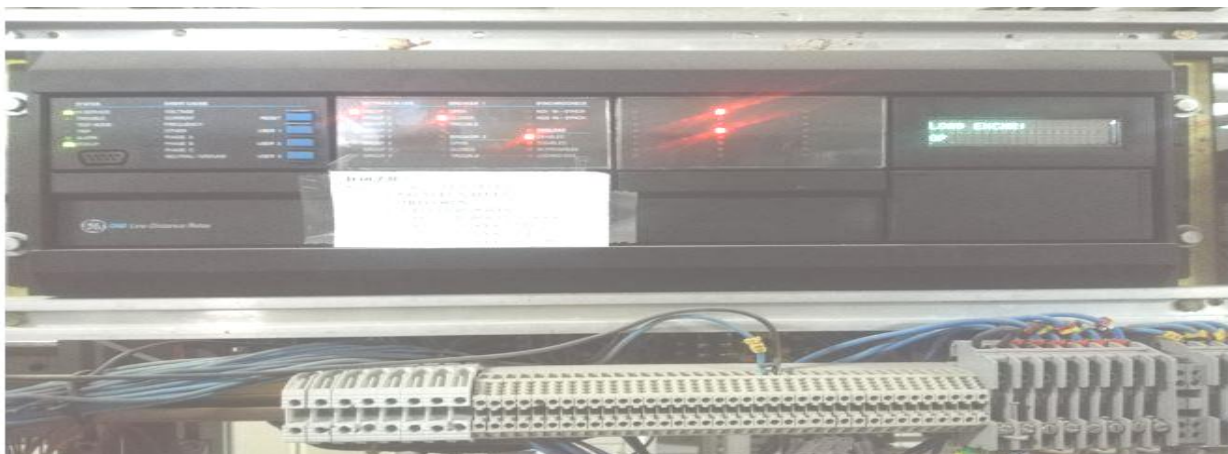
Fig.I.13 relais numérique minimum d'impédance Poste GRTE 220KV/60 et 30 KV Biskra
