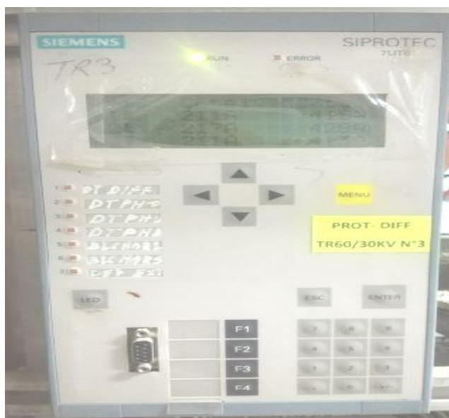
Fig.I.14 relais numérique Protection différentiel transformateur Poste GRTE 220KV/60 et 30 KV Biskra
