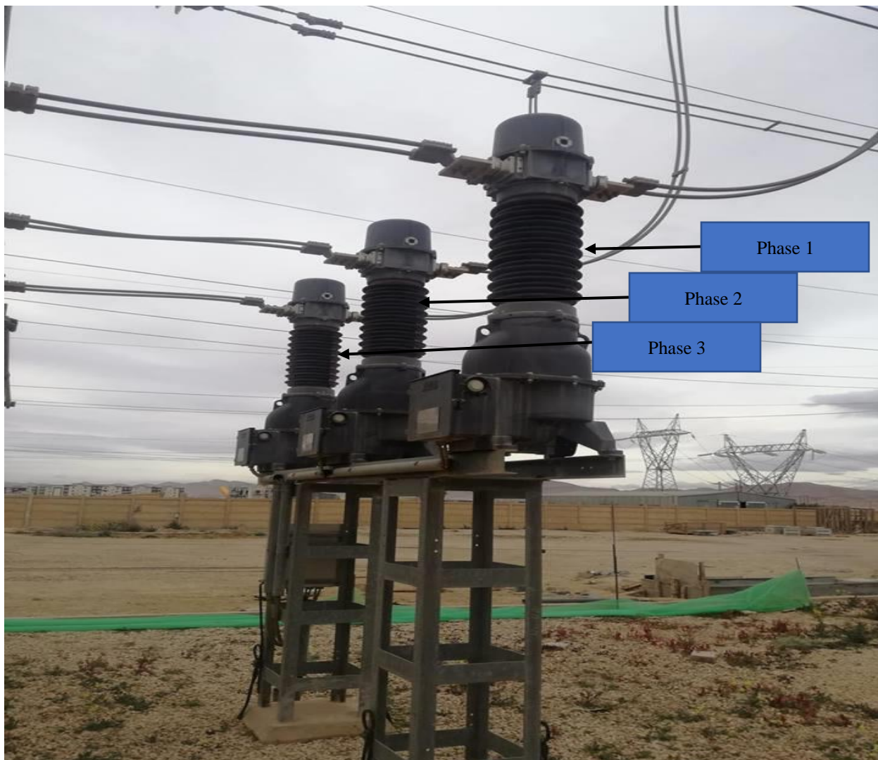
Fig.I.3 Transformateur de courant de Poste GRTE 220KV/60KV et 30KV Biskra
