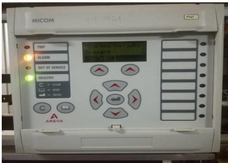
Fig.I.11 relais numérique Maximum courant Poste GRTE 220KV/60 et 30 KV Biskra
