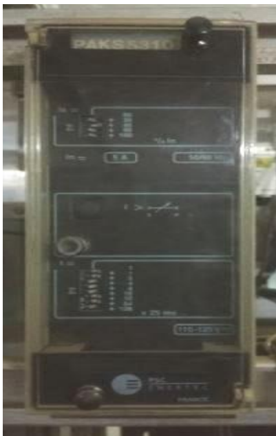
Fig.I.10. Relais statique à Maximum courant Phase Poste GRTE 220KV/60 et 30 KV Biskra
