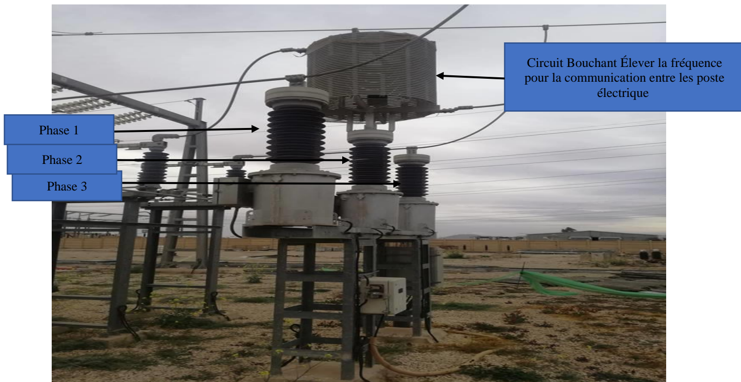
Fig.I.7 Transformateur de tension, de tension nominale Poste GRTE 220KV/60KV et 30KV
