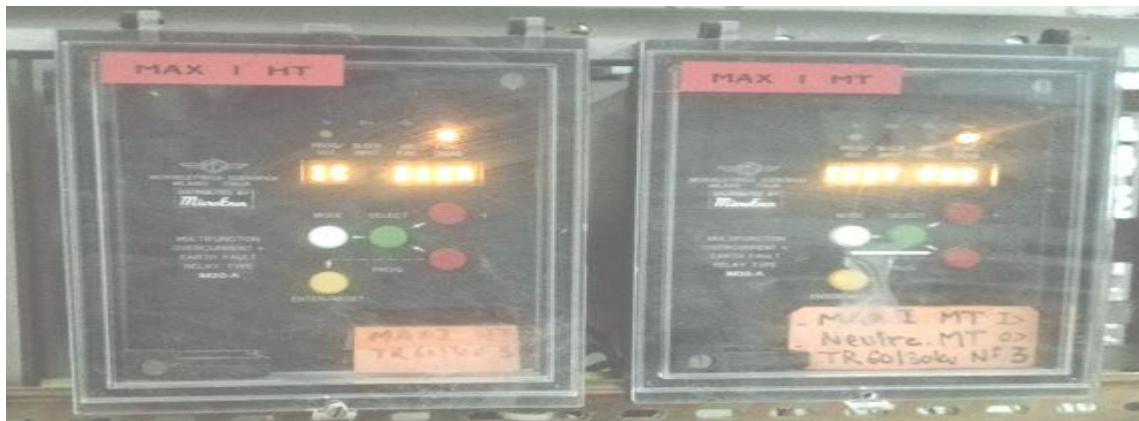
Fig.I.12 relais numérique Maximum courant Phase et Terre Poste GRTE 220KV/60 et 30 KV Biskra
