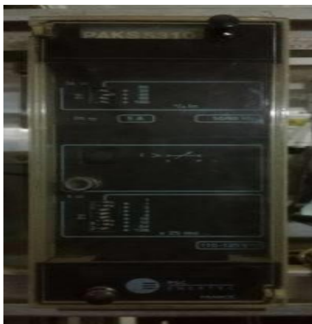
Fig.II.10 : Relai statique poste GRTE 220KV/60KV/30KV Biskra
