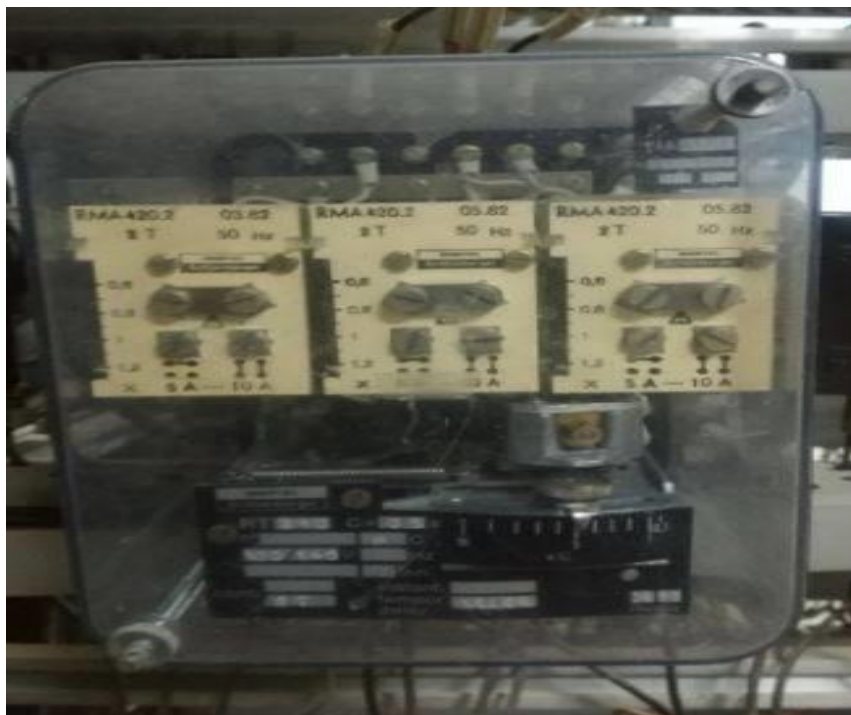
Fig.II.9 : Relai électromécanique poste GRTE 220KV/60KV/30KV Biskra
