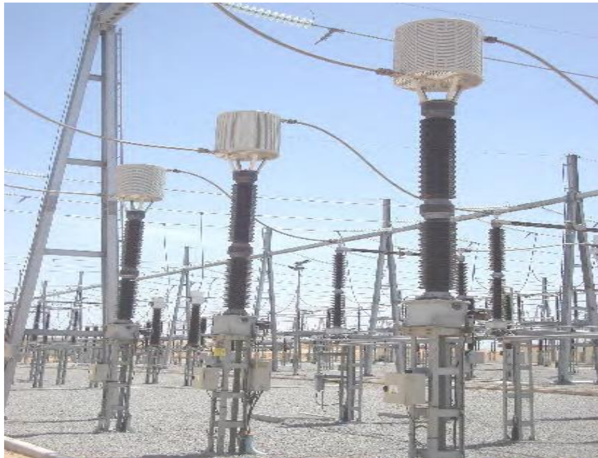
Fig.II.7 - Transformateur de tension (TT)[9]
