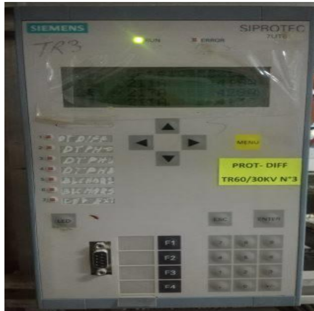
Fig.II.11 : Relai numérique poste GRTE 220KV/60KV/30KV Biskra
