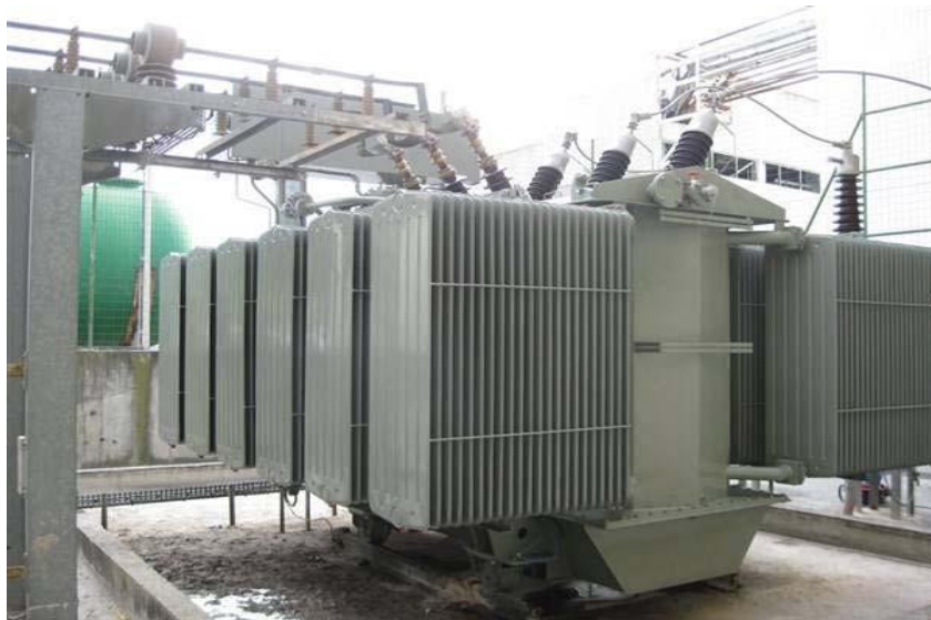
Fig. I.1: Transformateur de puissance.
