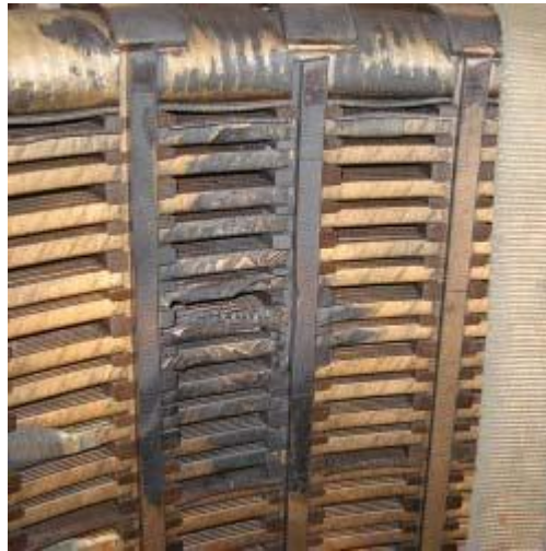
Fig. II.11 : Défaut de type diélectrique
