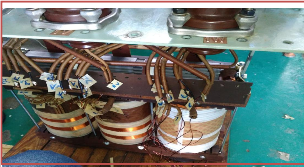
Fig. III.19 : Connexion des câbles d'alimentation et les fils du changeur de prise.
