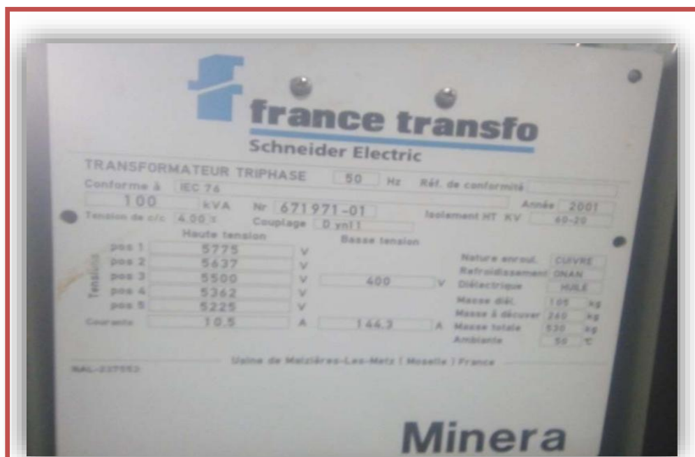
Fig. III.1 : Plaque signalétique du transformateur MT/BT.
