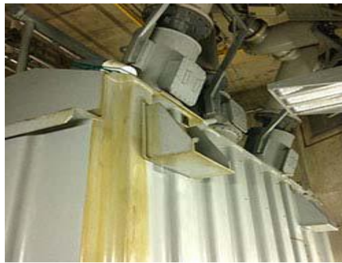
Fig. II.13 : Fuite d'huile du transformateur
