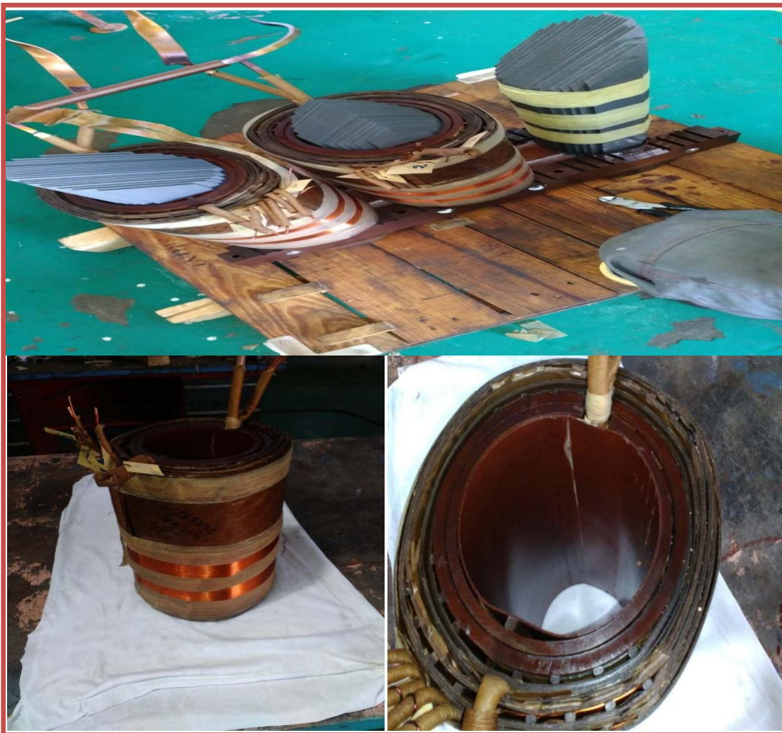
Fig. III.12 : Ces photos montrent le démontage du bobinage défectueux de la colonne du Circuit magnétique pour la phase A.
