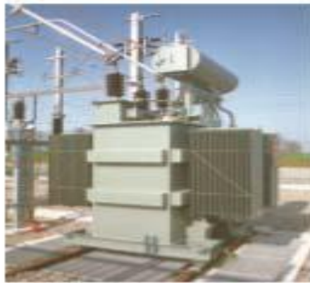
Fig. I.23 : Transformateur de distribution a diélectrique liquide
