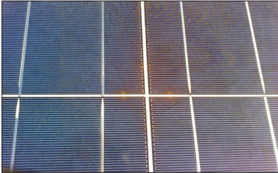
Figure III - 2. Dégradation des modules photovoltaïques par décoloration
