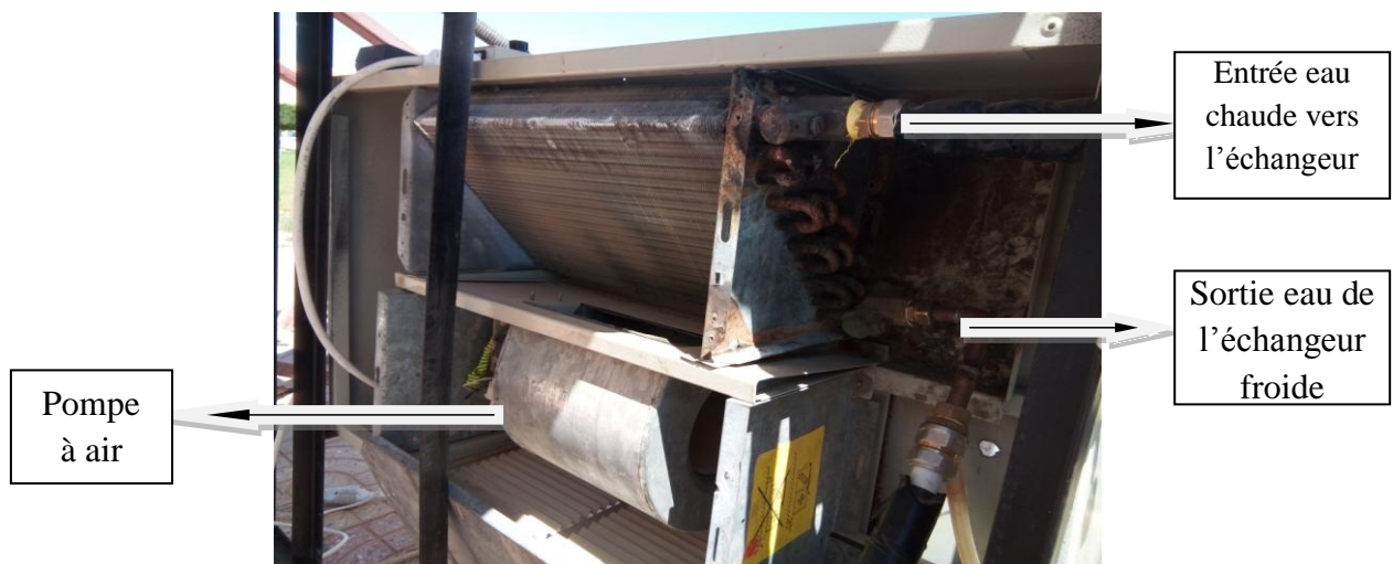
Figure III.9 : vue intérieur de l'échangeur de chaleur.
