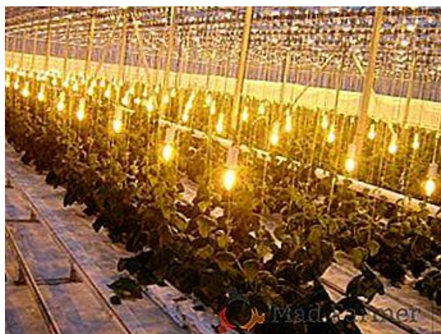
Figure I.13 : Eclairage SHP dans une serre agricole [15]
