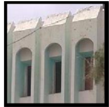
Figure 0-3 : Brise soleil utilisé dans toutes les orientations dans l'ancien siège de l'administration centrale de l'université de Biskra ).
