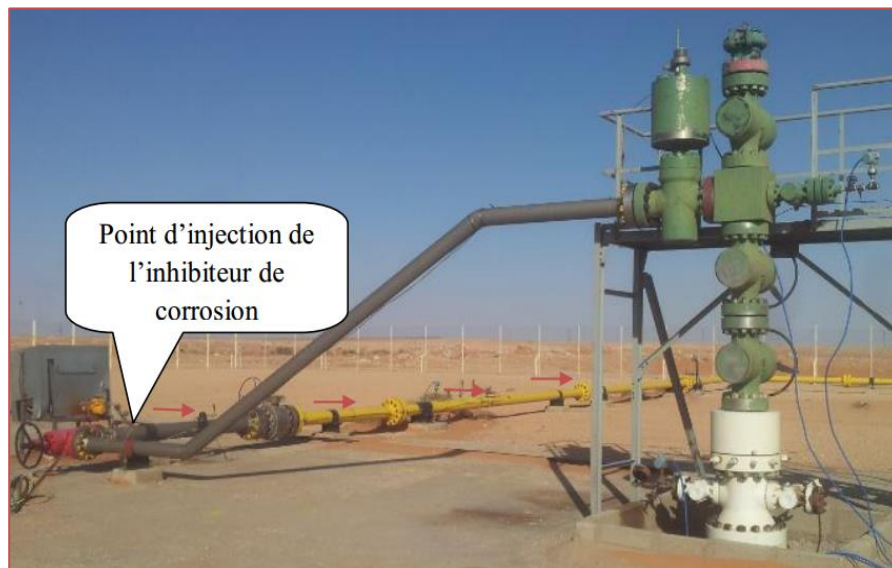
Figure (II.6) : Point d'injection de l'inhibiteur de corrosion au niveau du puits.
