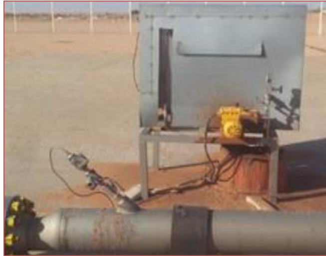
Figure (II.7) : Pompe doseuse responsable à injecter l'inhibiteur de corrosion.
