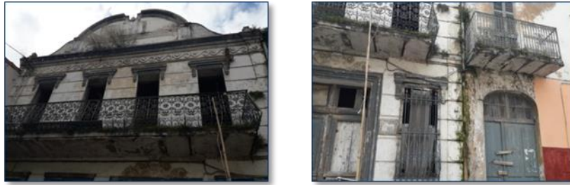
Photo 10 Photos reprenant le mauvais état des constructions et des façades Source : Auteur (2018)
