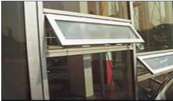
الشكل 01-45: نظام التهوية في المبنى (صيف. شتاء)
