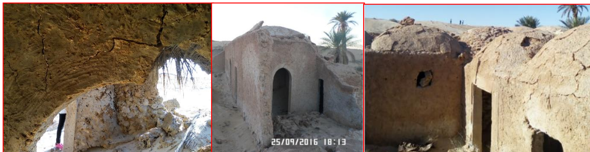
Photo (III-17) : dégradation des couverture (les fissures).(Source : Auteur / 2017)
