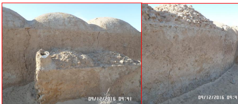
Photo (III-14) : les fissures au niveau du mur (Source : Auteur / 2017)
