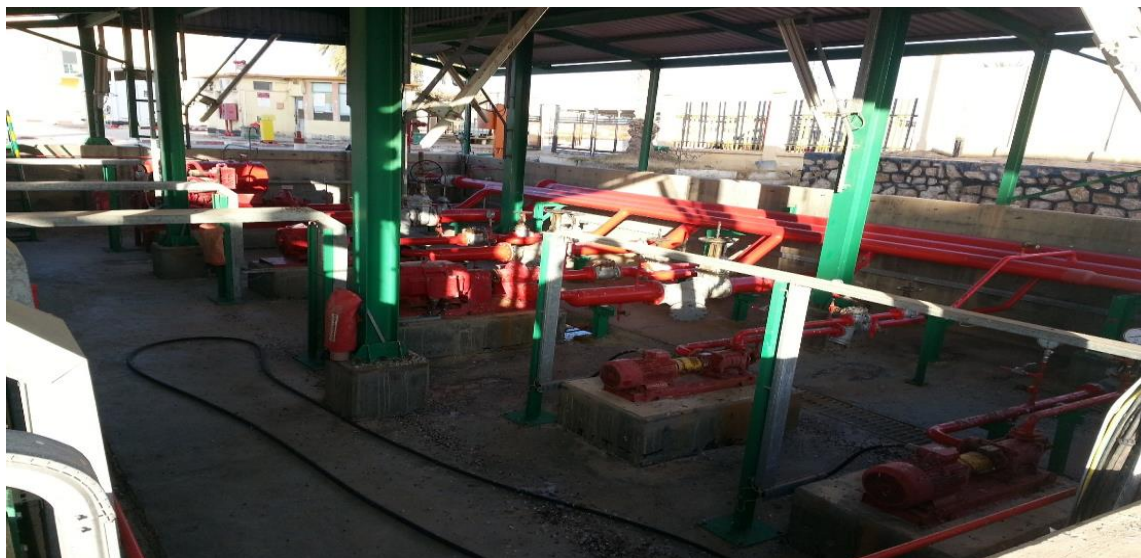
Figure I-8 : la centrale incendie
