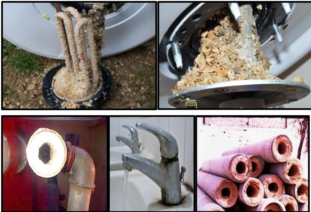
Figure 3: Entartrage des appareils et des canalisations d'eau (www.google.com).
