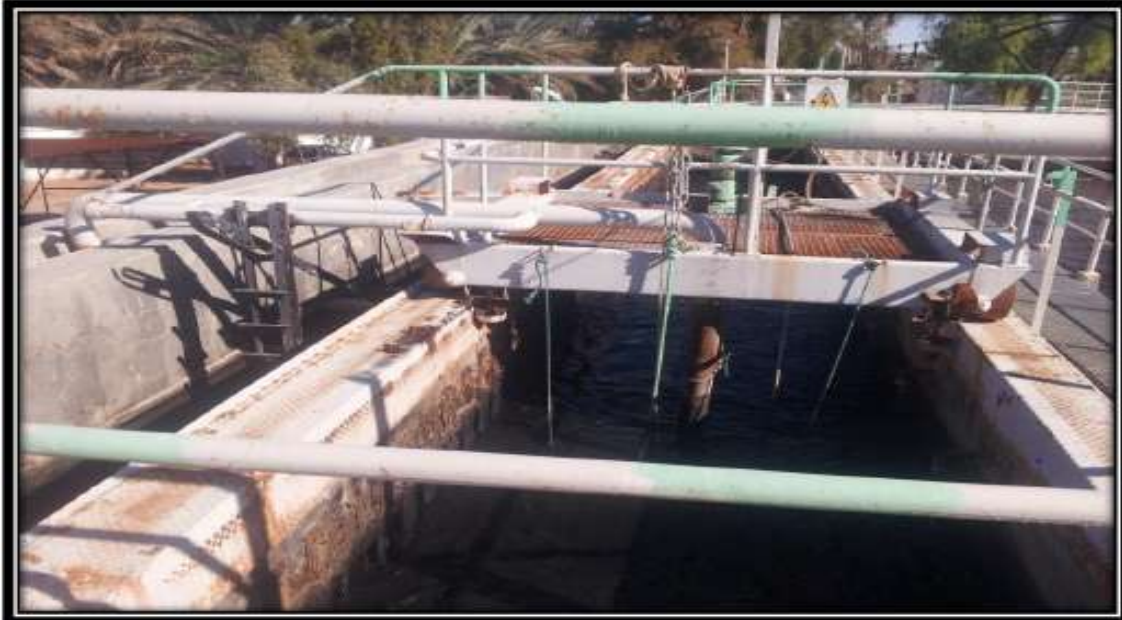
الصورة رقم 5 : حوض إزالة الرمال والزيوت
