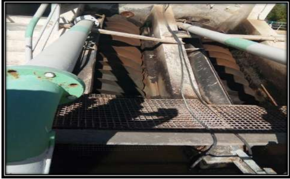
الصورة 8 : لولب إعادة الحمأة المنشطة
