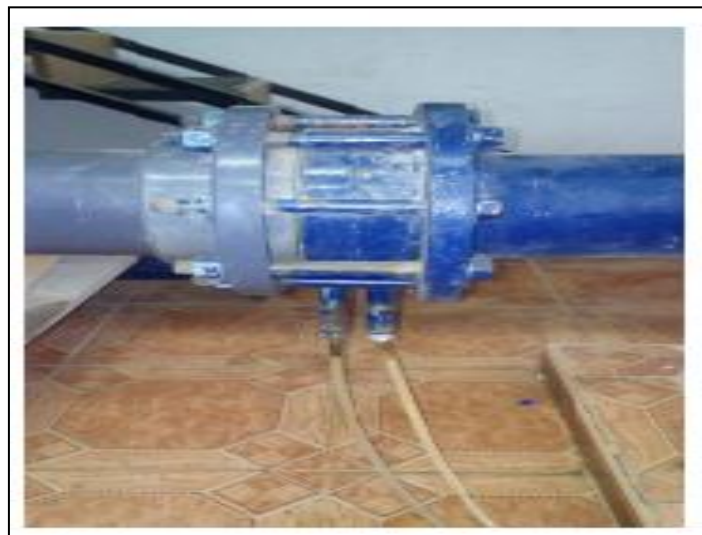
Photographie (1.10) : débitmètre à diaphragme.
