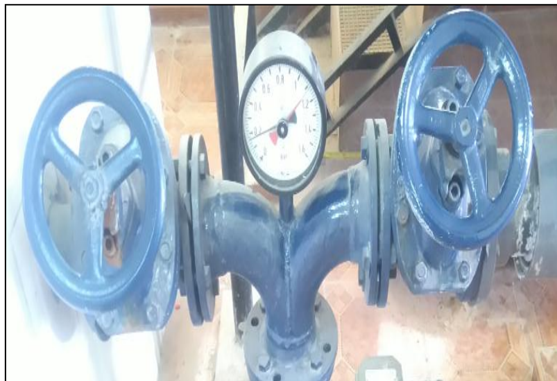
Photographie (1.6) : les deux vannes.
