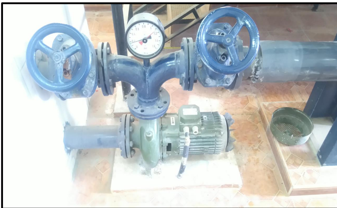
Photo (1.6) : Vannes de régulation de débit.
