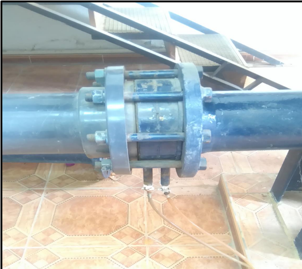
Photo (1.8) : débitmètre à diaphragme
