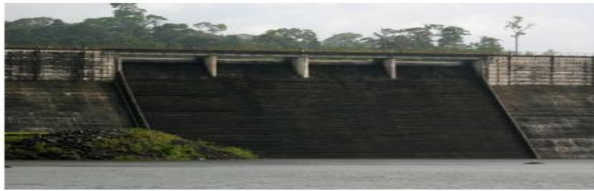
Figure (II.12) : barrage de Petit-Saut sur le fleuve Sinnamary (Guyane française), combinant un déversoir libre standard et un coursier en marches d'escalier – (site : http://webtice.acguyane.fr ).
