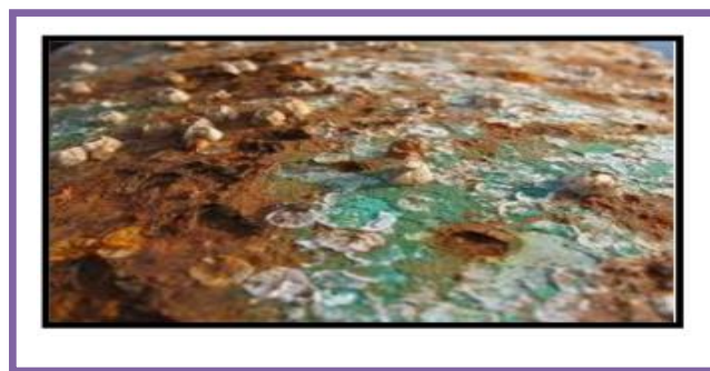
Fig (I.2) : Corrosion caverneuse.
