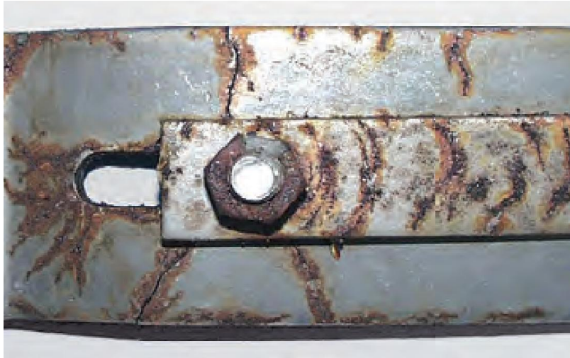
Figure I.8 : Corrosion sous contrainte [15].
