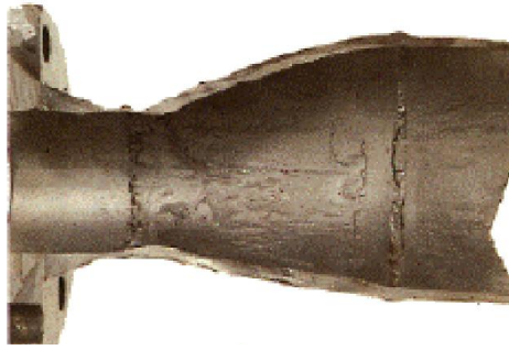
Figure I.6 : Corrosion-érosion dans une zone turbulente [14].
