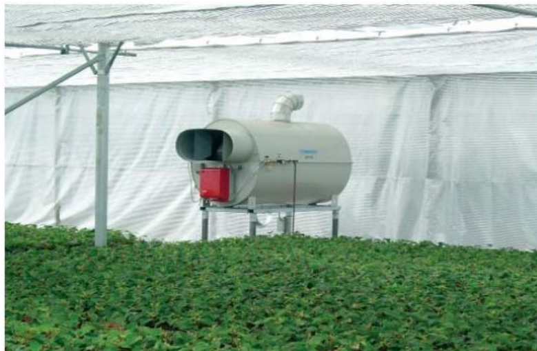
Fig.15 : Exemple d'appareil de chauffage utilisé dans les serres (ULMA., 2018)
