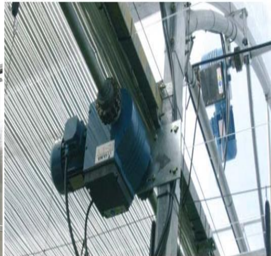
Fig.12 : Ventilation par des fenêtres automatiques (ULMA, 2018)
