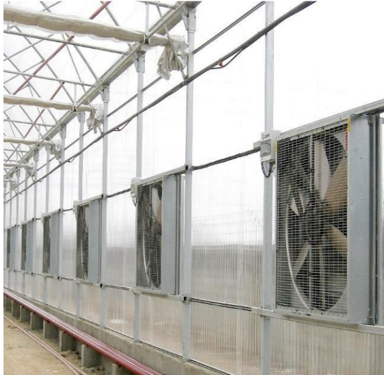
Fig.11 : Ventilation par extracteur d'air (ULMA, 2018)
