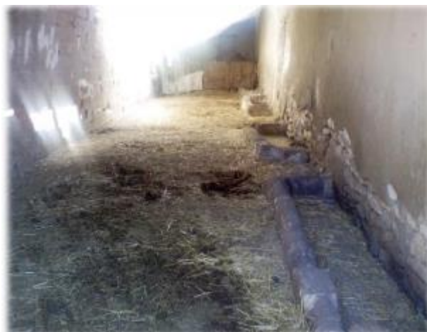
Figure 8 : Exemple d'un bâtiment médiocre(mauvaise litière, état désastreux des murs)
