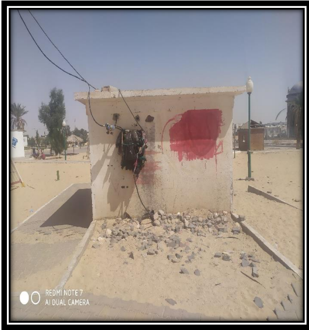
صورة رقم (26) توضح المولد الكهربائي
