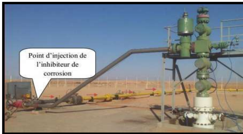
Figure II.10. Point d'injection de l'inhibiteur de corrosion au niveau du puits.
