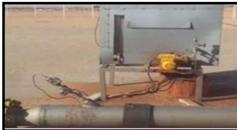
Figure II.11. Pompe doseuse responsable à injecter l'inhibiteur de corrosion.
